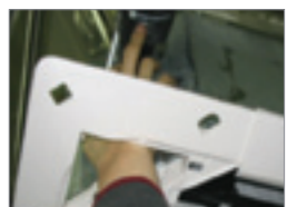
A cseppvíz szivárgásának ellenőrzése
